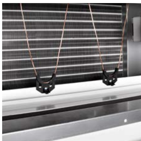
Dispositif de protection contre le gel sur la batterie de chauffage
